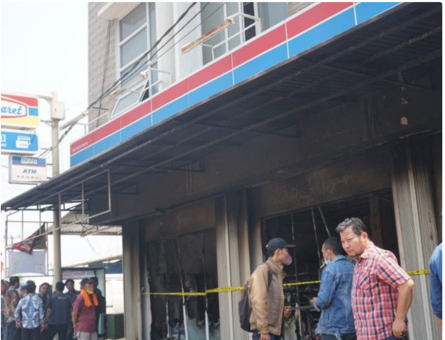
Indomaret Jalan Raya Rajeg Mulya yang kebakaran, Selasa (5/9). Foto: Dokumentasi
